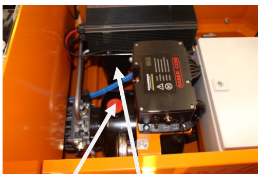
Hydraulbehållare och tryckfilter
